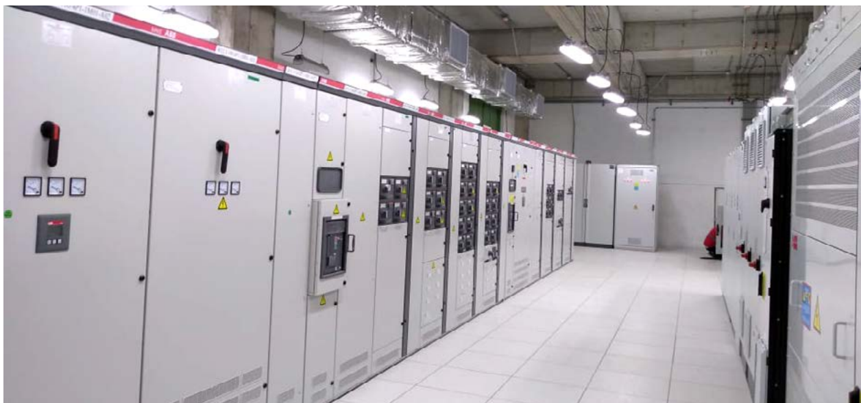
Cabinas eléctricas en subestación.
