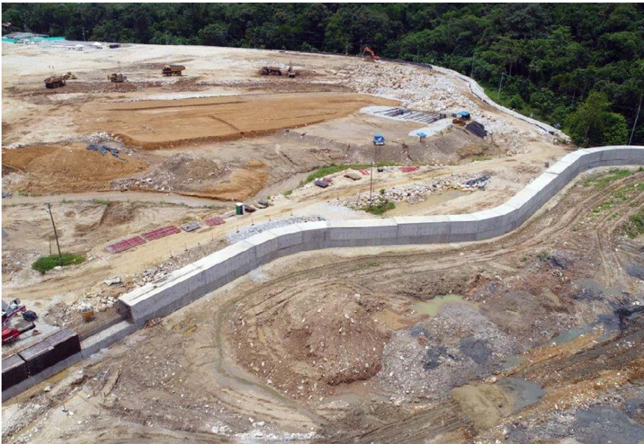
Imagen aérea de box-culvert en el paso por el área de producción.
